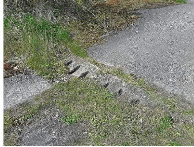
Abfluss für Oberflächenwasser
